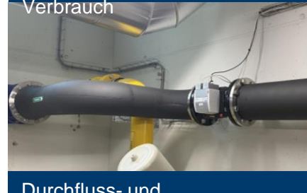
Durchfluss- und Temperaturmessungen für warmes Wasser
