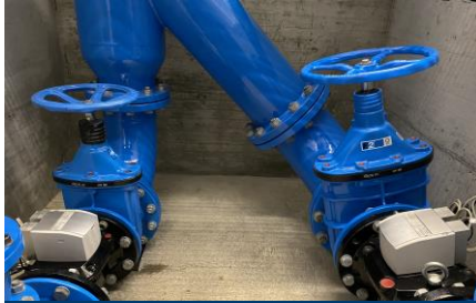
Pumpwerke & Wasserkraftwerke direkt nach
