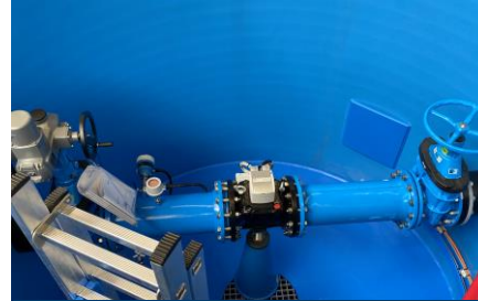
Wasserverteilung zur Steuerung von Durchflussmengen und Verbrauch
